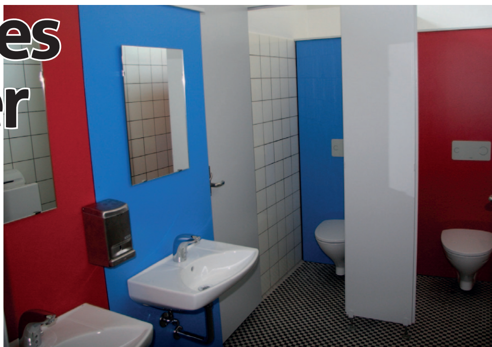
...men nu ser toiletfaciliteterne sådan ud på Pilegårdsskolen.
